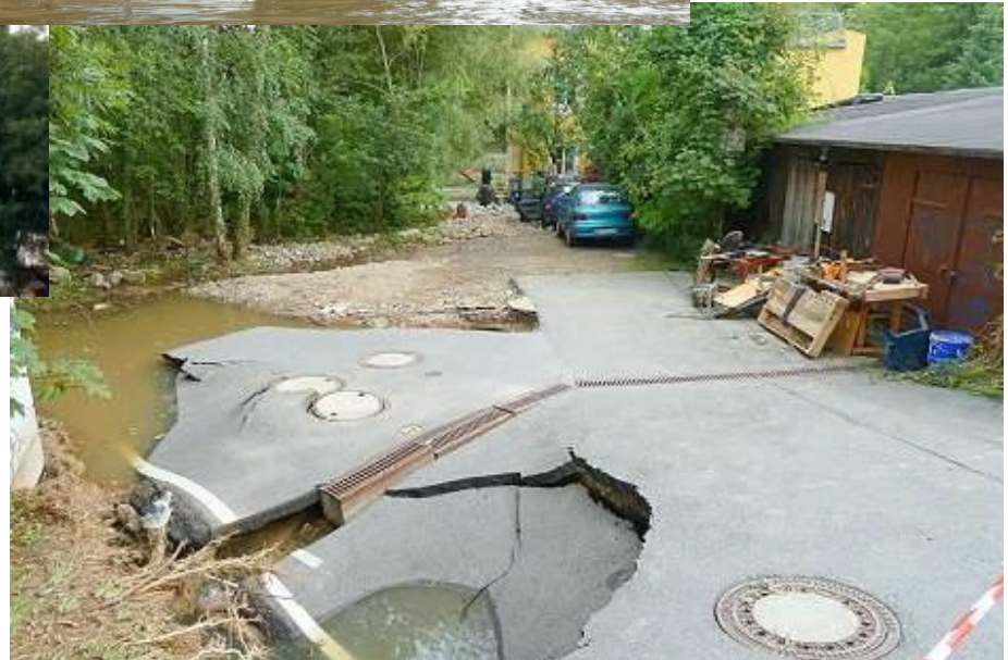
Schäden durch Hochwasser der Spree bei Bautzen,
