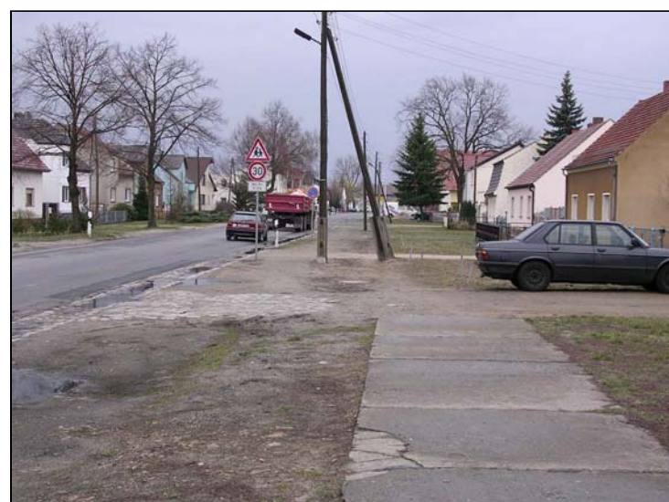
Bild 3-4: Dissenchener Schulstraße - abruptes Radwegende eines gemeinsamen Geh- und Radweges mit schadhaftem alten Plattenbelag
