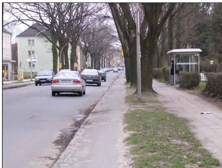
Bild 3-1: Sielower Landstraße – Radweg mit Belagsmängeln, ohne Sicherheitstrennstreifen bei geringer Breite
