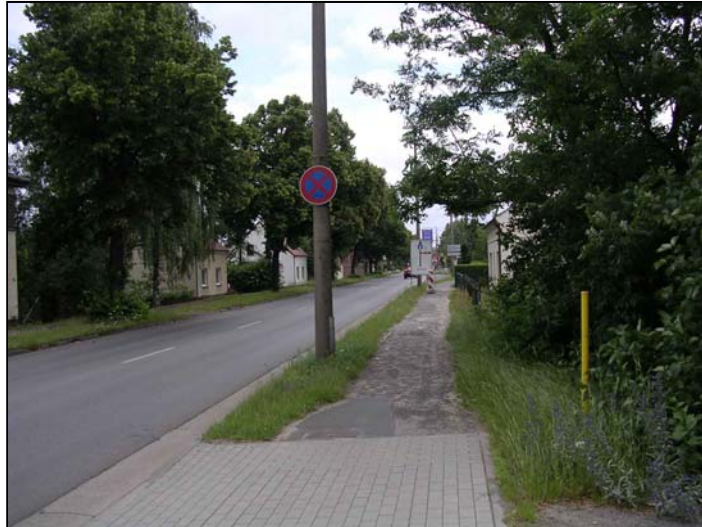
Bild 5-30: Geh- und Radweg mit deutlichen Belagsmängeln im Zuge der Saarbrücker Straße.
