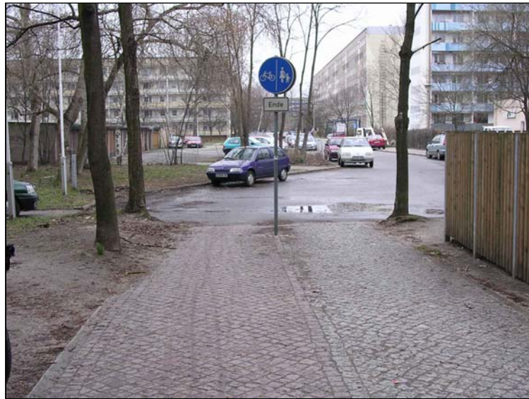
Bild 5-19: A.-Förster-Straße – neuer Radweg mit Belagsmängeln
