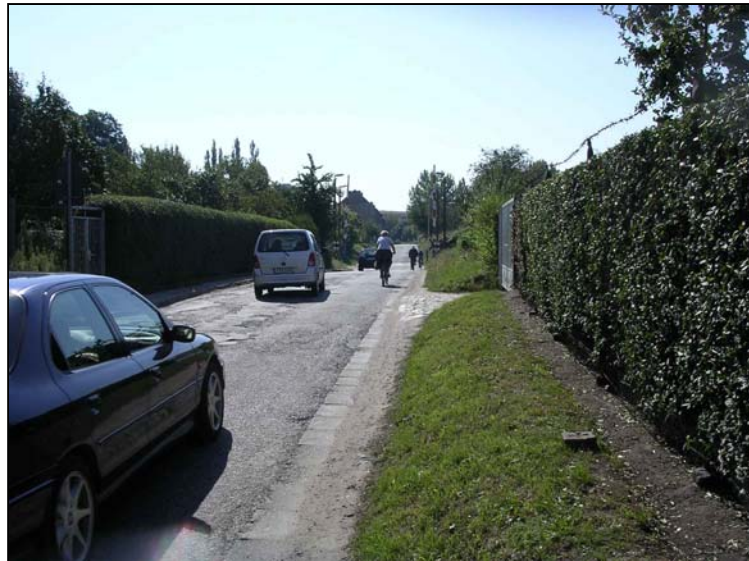
Bild 5-33: Belagsprobleme im Zuge der Sachsendorfer Straße
